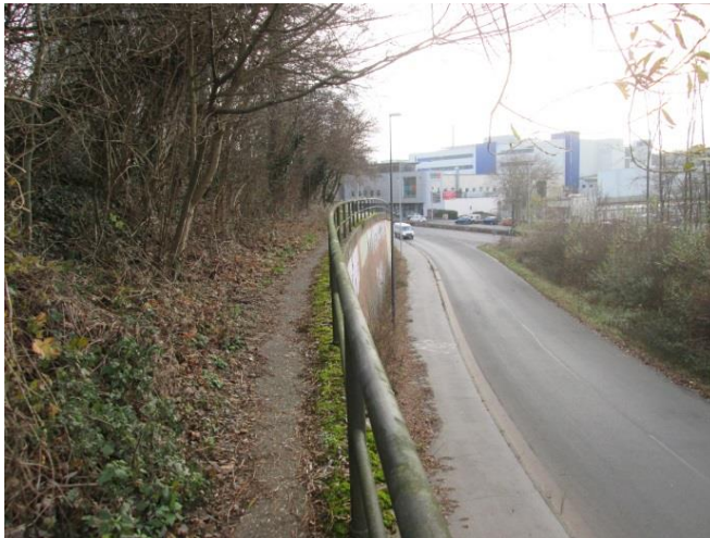
Abb. 88: Roermonder Straße (Stützwand) Bestand, Fehlende Geh- und Radweganlage
